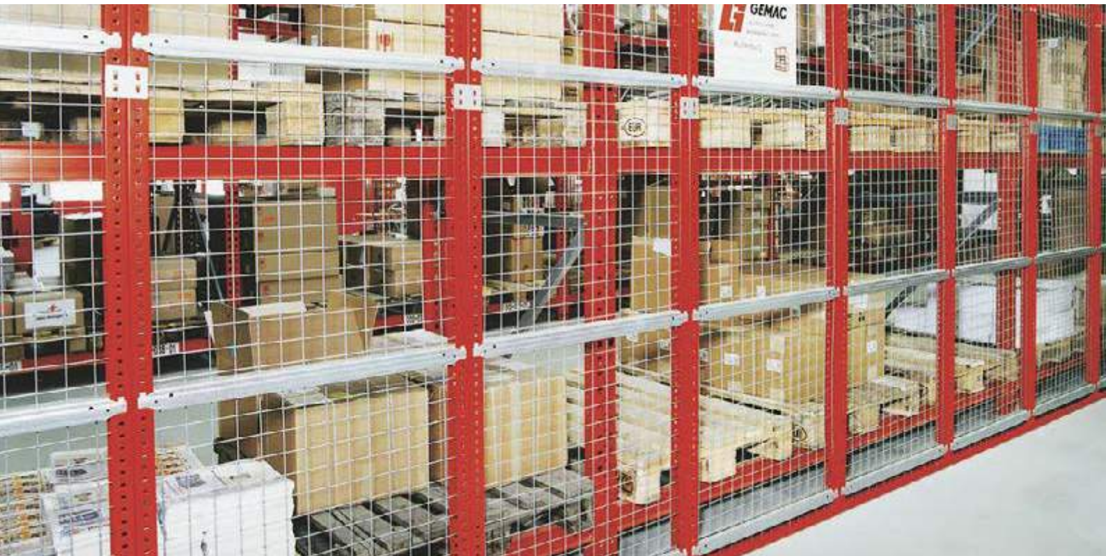
NP Gitterrückwand: Die nicht für die Be- und Entladung vorgesehenen Seiten von Regalen müssen gegen Herabfallen von Ladeeinheiten gesichert sein.
