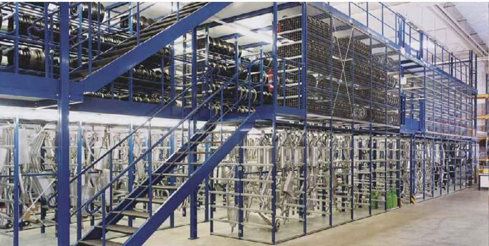
3-geschossige Fachbodenanlage mit vollflächiger Bühnenabdeckung.
