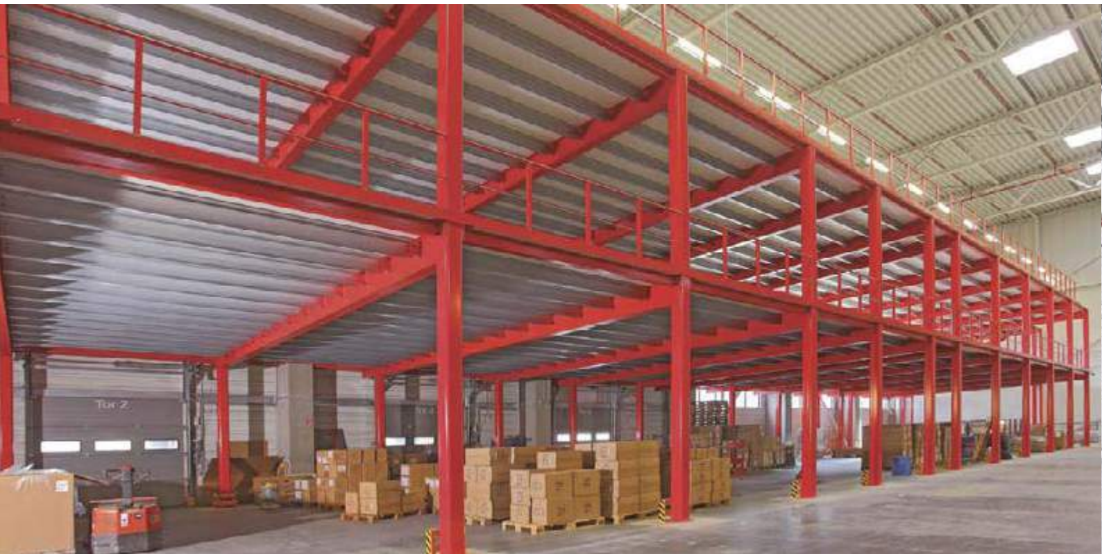
2-geschossige Lagerbühne mit Schutzgeländer. Branche: Versandhandel
