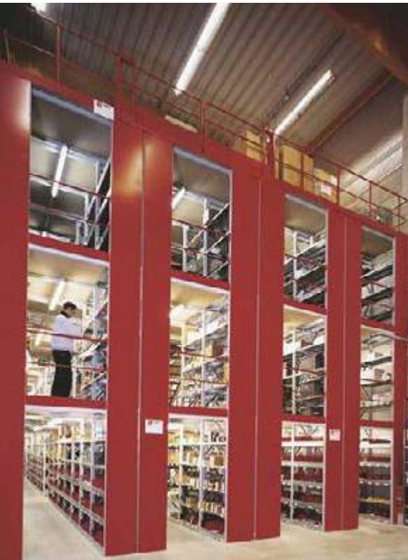
4-geschossige Fachbodenregalanlage mit Lagerbühne, Schutzgeländer, Klapptor und Vollblechstirnwände. Branche: Heizung- und Sanitärgrößhandel
