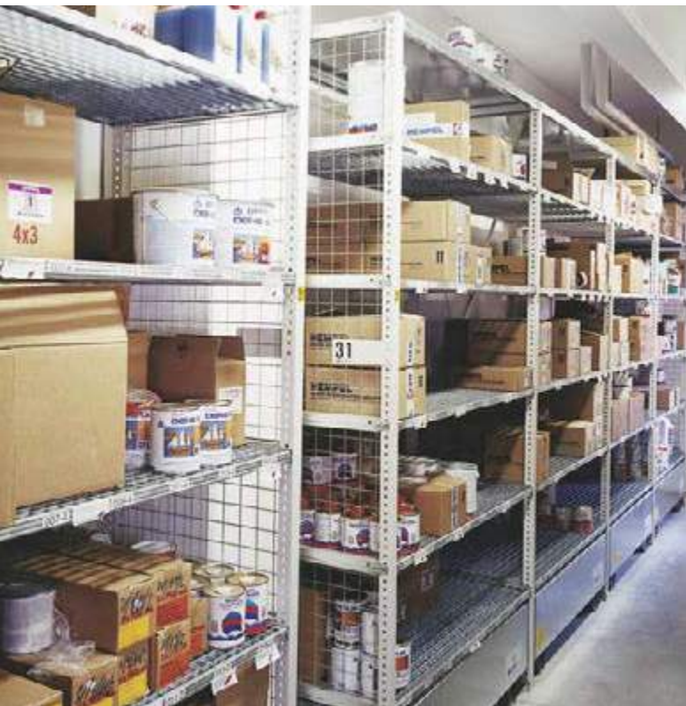
Fachbodenregal mit Gitterrostböden und Auffangwanne für die Lagerung von gefährlichen Gütern. Branche: Chemische Industrie
